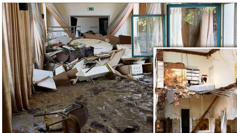
Rheinland-Pfalz, Bad Neuenahr: Der Kursaal in Bad Neuenahr ist komplett verwüstet. Fotos: Frey
